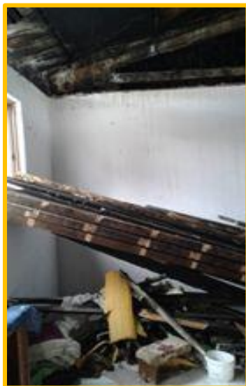
Interno di una delle stanze dopo l'incendio
